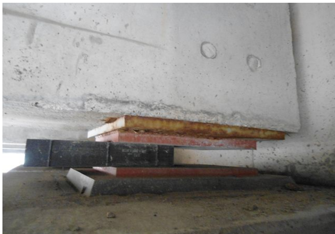
A1-SH7 교량받침 본체 이탈
