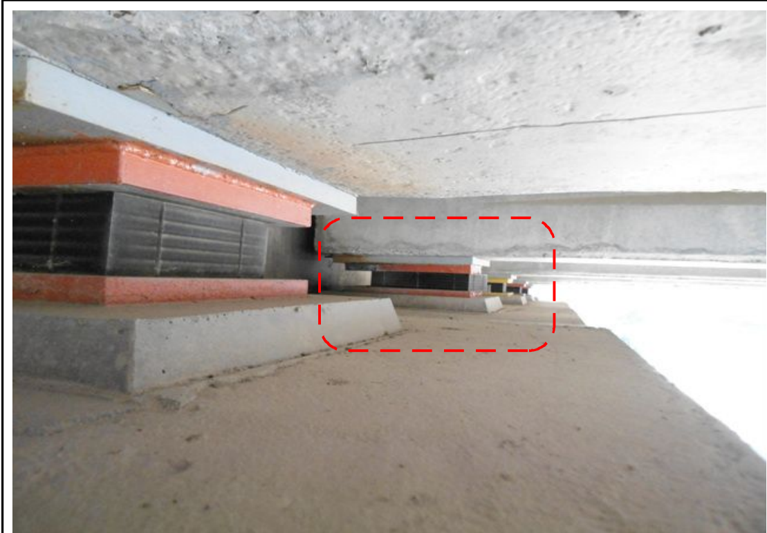
A1-SH5 교량받침 본체 이탈
