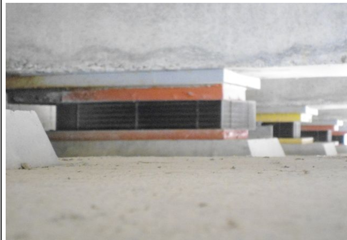
A1-SH5 교량받침 본체 이탈
